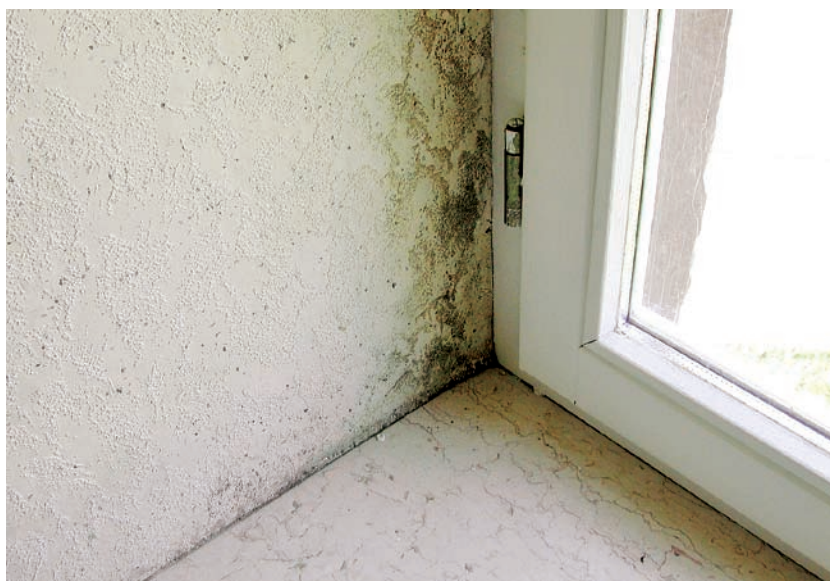
Obr. 1: Plíseň je v okolí napojení okna k ostění je nejčastěji důsledek nesprávně provedené připojovací spáry, která je netěsná a špatně tepelně izoluje.
